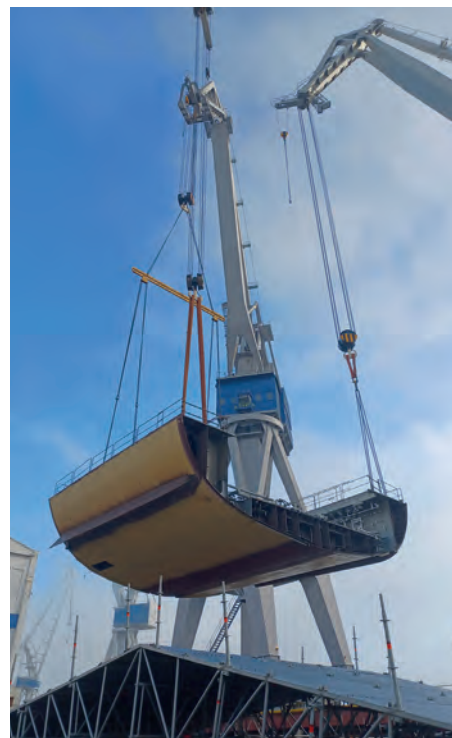
Maniobra de instalación de uno de los 33 bloques que conforman la estructura del buque.
